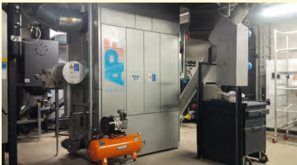
ABB. 27: AUFBEREITUNG VON GRÜNGUT; HEIZANLAGE IM LANDRATSAMT SIGMARINGEN
